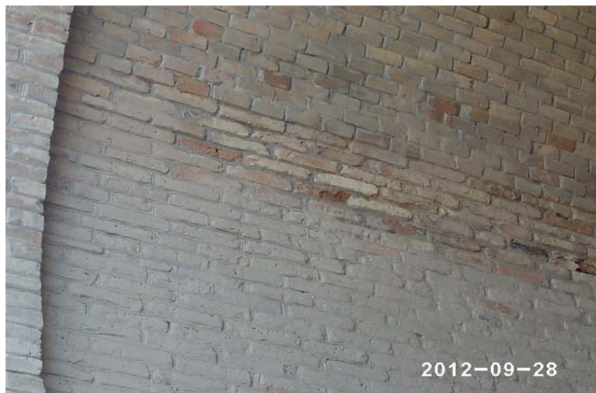
Рисунок 2 – Разрушение кирпичной кладки мавзолея Арыстанбаба
