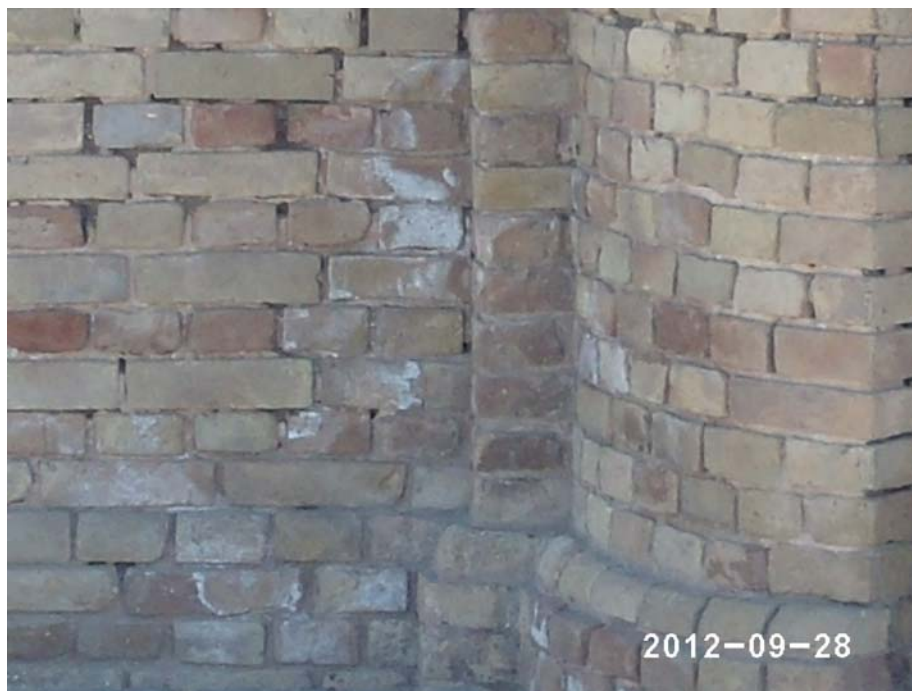
Рисунок 5 – Сыростные пятна на стенах и фундаментах мавзолея Арыстанбаб
